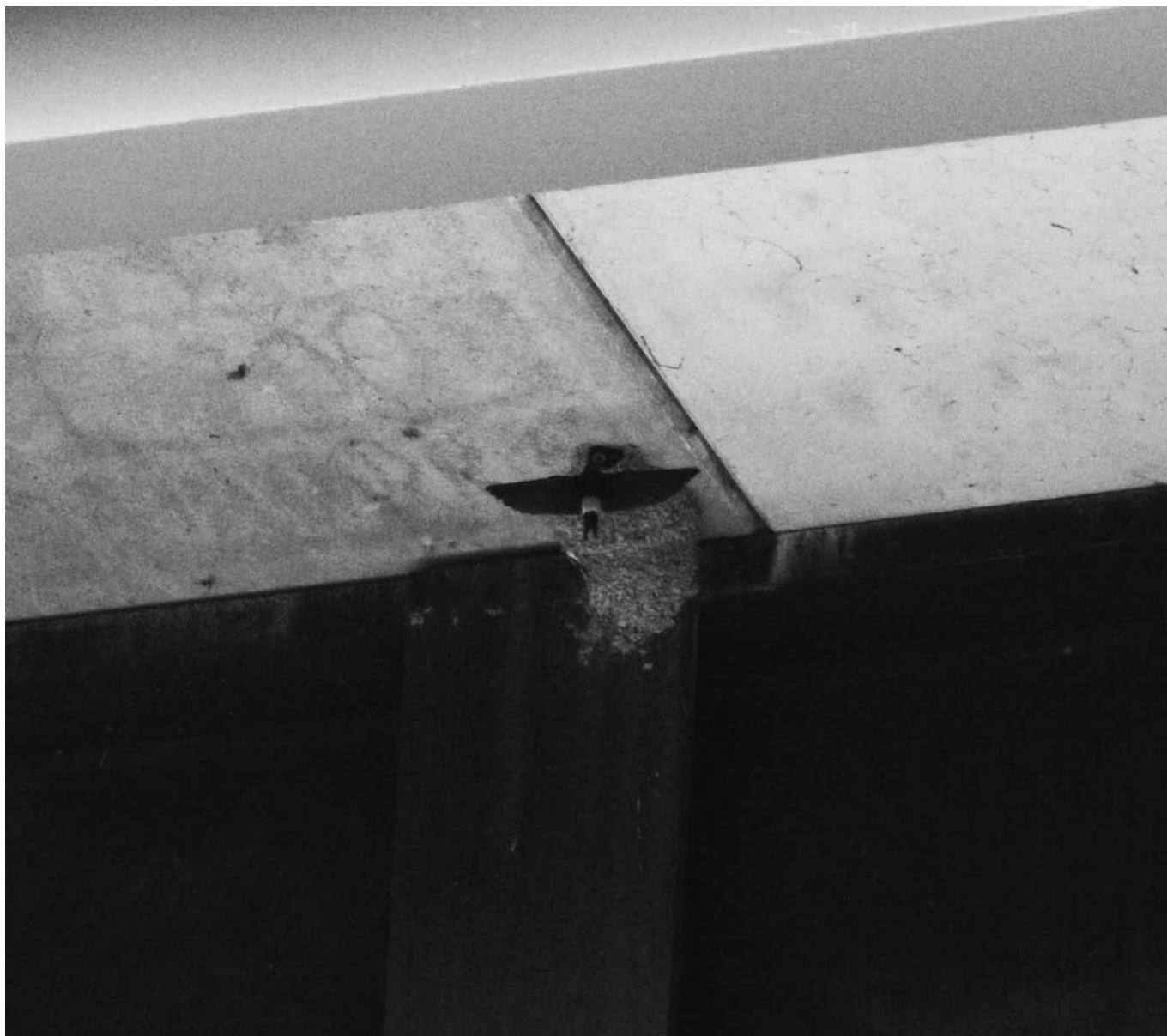
Nido de golondrina en uno de los viaductos. Fotografía de Manuel Fernández Pajuelo.
